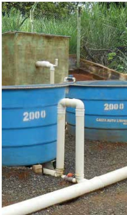
Figura 10 - Tubo coletor da água efluente das caixas de produção (150 mm)
