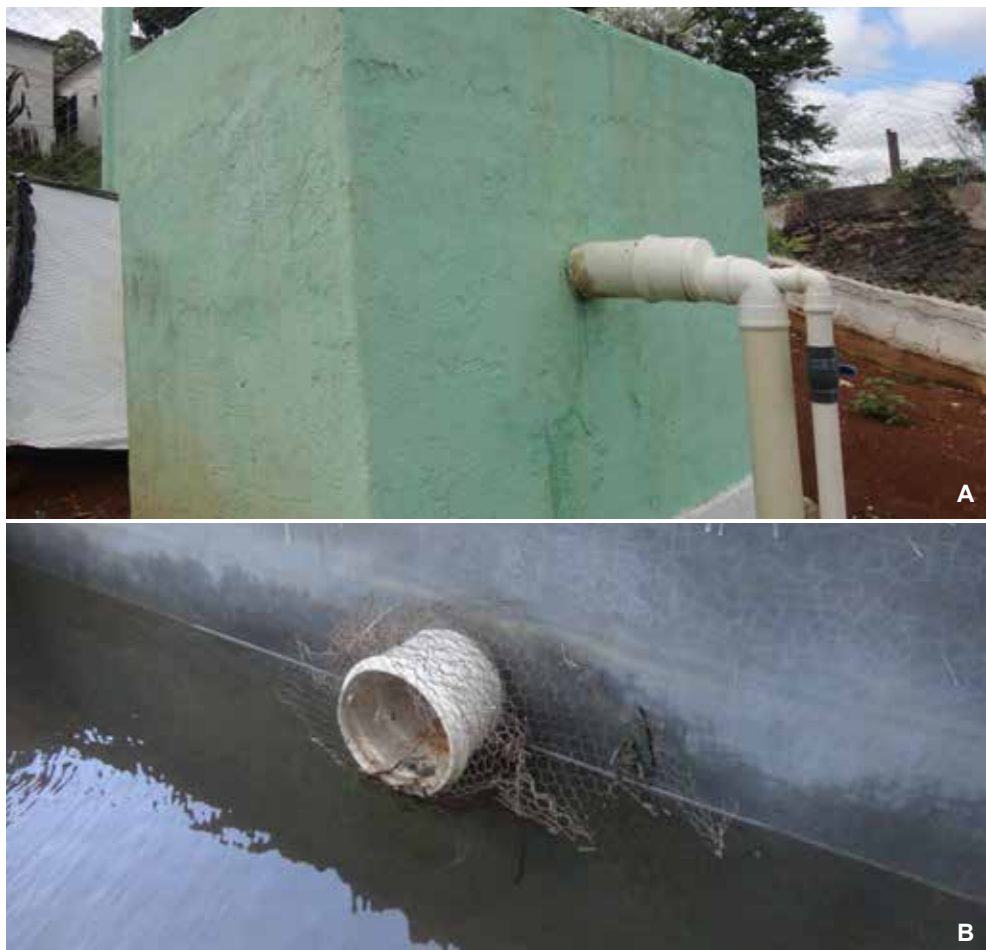
Figura 5 - Tanque de captação e distribuição de água
