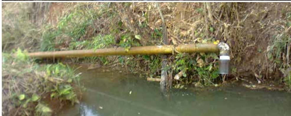
Figura 4 - Canal de adução e filtro colocado na entrada do tubo de derivação para o tanque de distribuição de água
