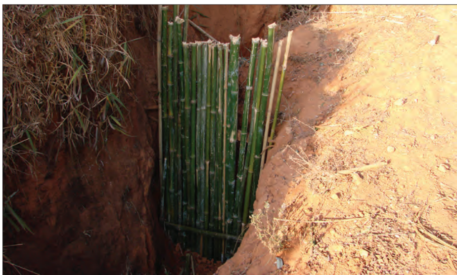
Figura 6 - Paliçada dentro de erosão em margem de estrada - Viçosa, MG
