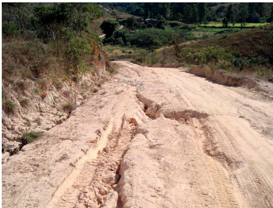
Figura 1 - Erosão em estrada não pavimentada
