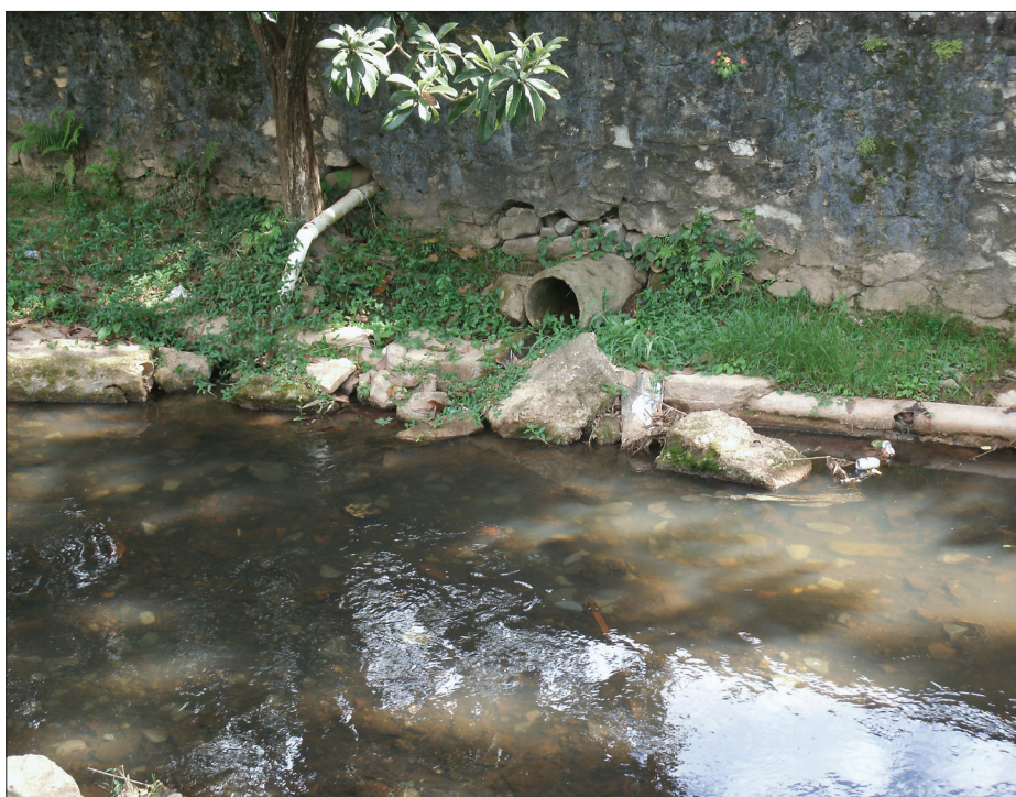
Figura 6 - Esgoto a céu aberto
