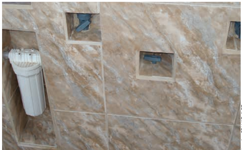
Figura 8 - Sistema de cloração da água de abastecimento da queijaria
