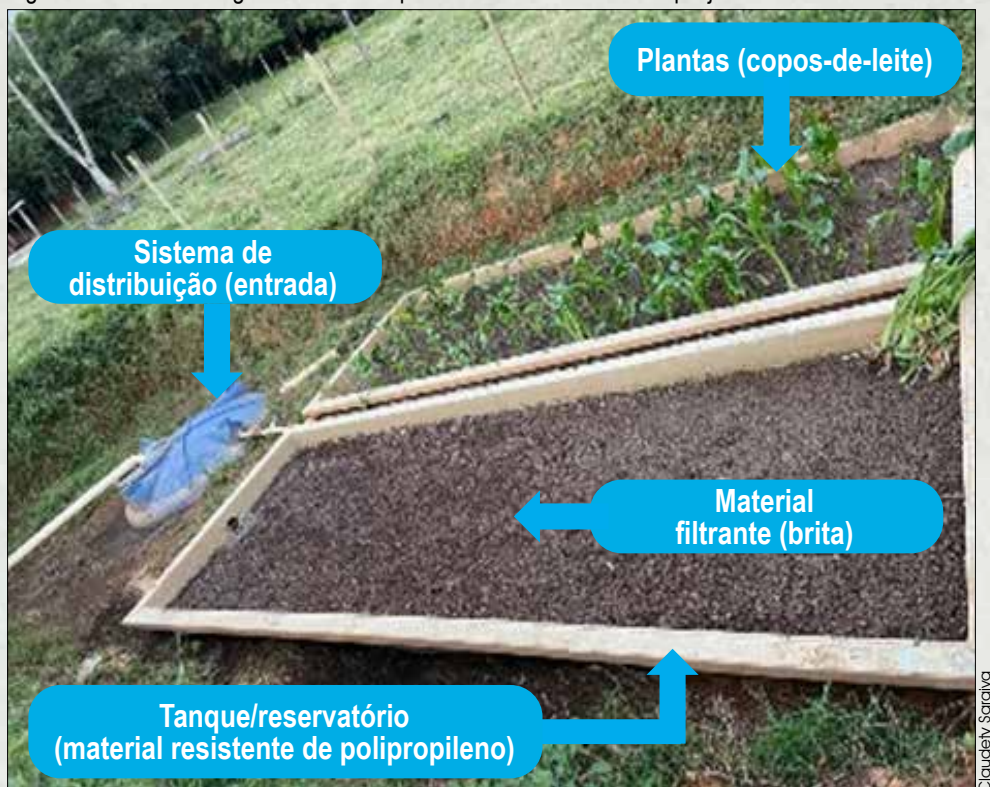
Figura 27 - Sistema Alagado Construído para tratar efluente de uma queijaria artesanal
