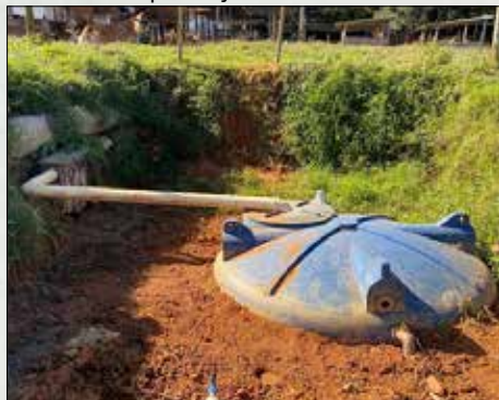
Figura 20 - Caixa de armazenamento/ equalização
