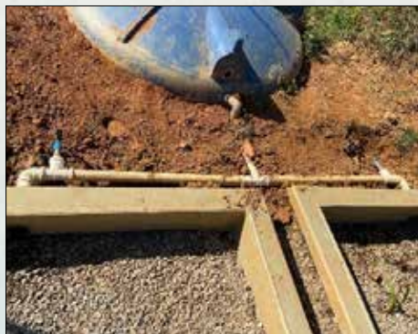
Figura 22 - Tubulação de saída do Sistema
