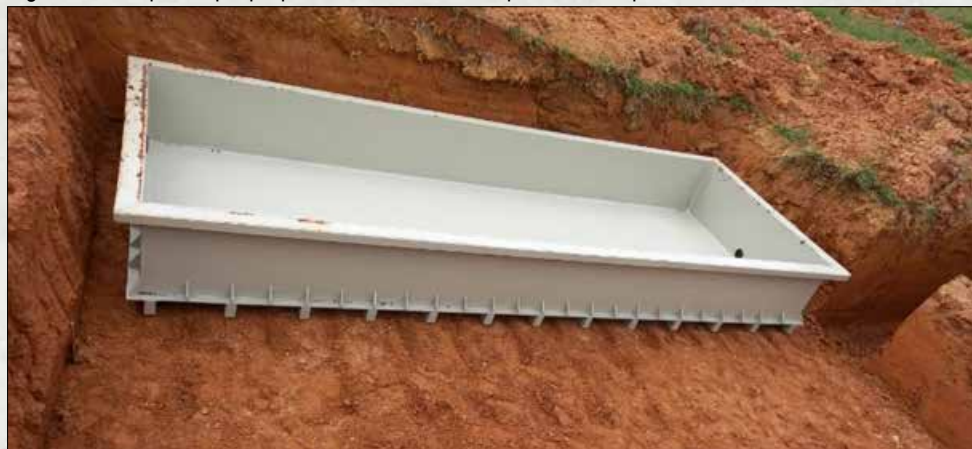
Figura 4 - Tanque de polipropileno com 8 mm de espessura das placas
