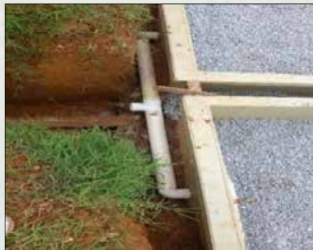
Figura 23 - Tubulação de saída do efluente
